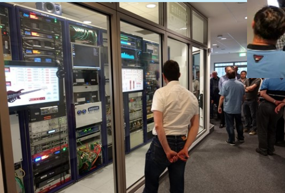
Das verglaste Rechenzentrum. Die schönsten Spezialserver stehen vorne an der Glasfront.
