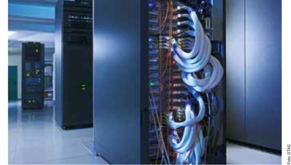
Telekom Cloud Rechenzentrum
