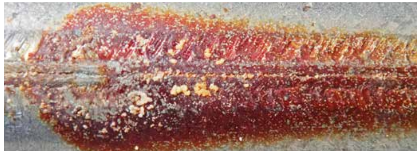
Längsschweißnaht eines Rohres mit Korrosionsangriff von außen
