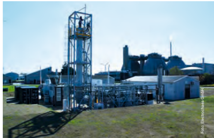
BioCat-Anlage in Avedøre, Dänemark
