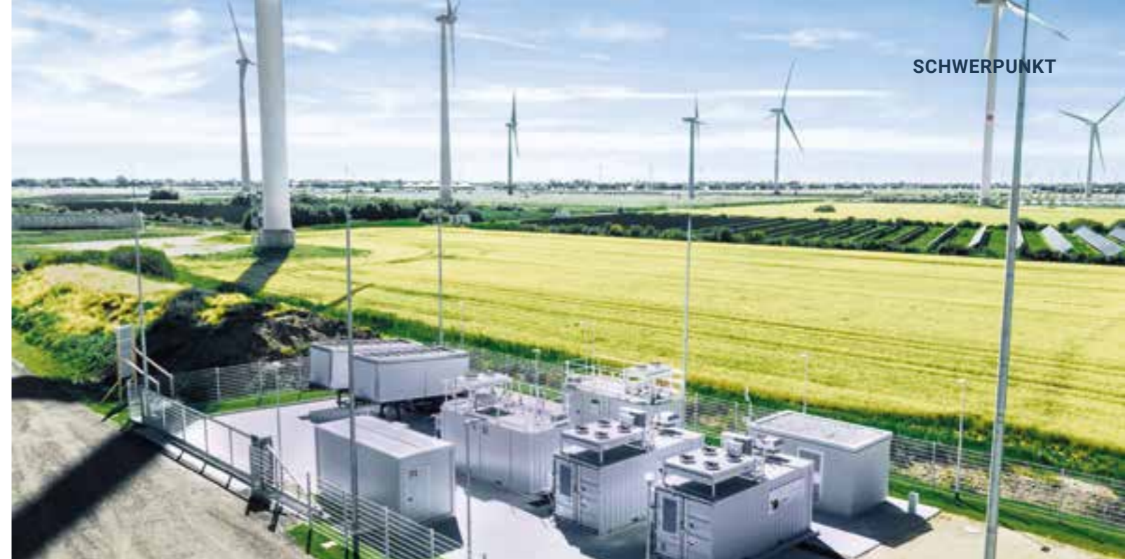
Top-Technologie im Container: Die H-TEC SYSTEMS Elektrolyseure wandeln auf kleinem Raum erneuerbaren Strom in grünen Wasserstoff um
