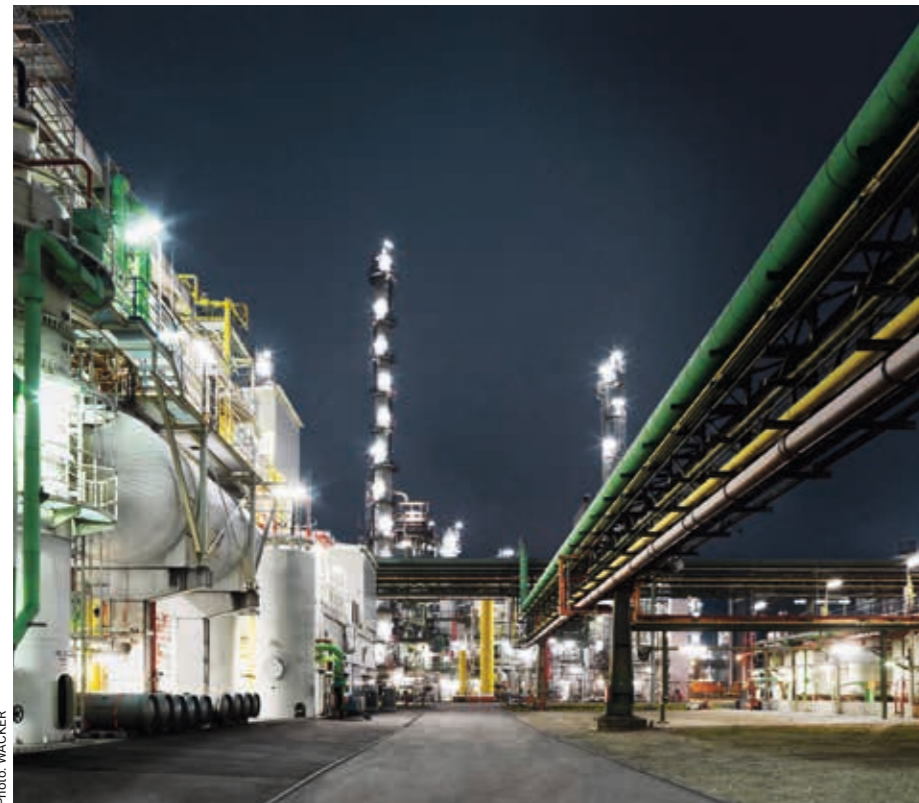
Kilometerlange Rohrbrücken charakterisieren das WACKER-Stammwerk im oberbayerischen Burghausen. Hier betreibt das international agierende Chemieunternehmen seinen größten Verbundstandort
